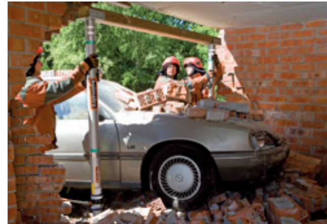
Positionnement des deux étais avec têtes de soutien de poutre et une poutre, pour stabiliser un bâtiment. Les étais hydrauliques à verrouillage par contre-écrou seront minutieusement déployés par une pompe manuelle.
