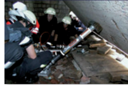
Stabilisation et levage de structures effondrées avec un système hydraulique à verrouillage par contre-écrou.
